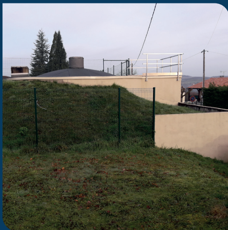
Réservoir semi-enterré du collège, Tocane-Saint-Apre.
