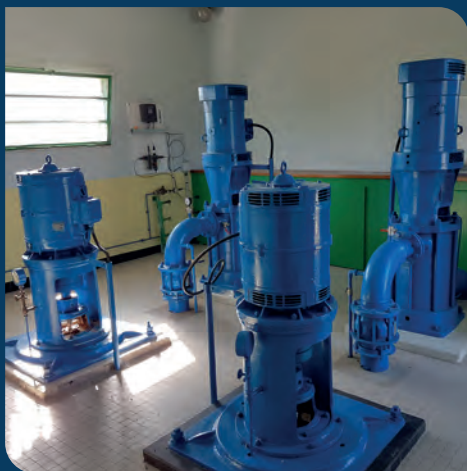
Forage et station de production de Thuilière, Saint-Front-de-Pradoux.
