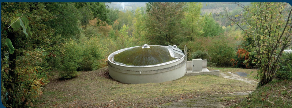
Réservoir semi-enterré, Site de Coustellerie, St Léon sur Vézère.
