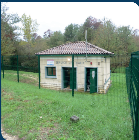
Puits et station de production de la Sinsonnie, Siorac de Ribérac.
