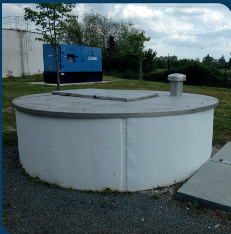
Station de production de Garrigues, Port-Saint-Foy-et-Ponchapt.
